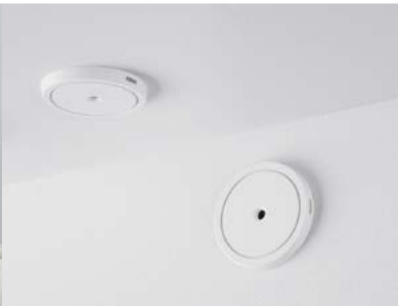
Direkte Luftbefeuchtung über Befeuchterspots
